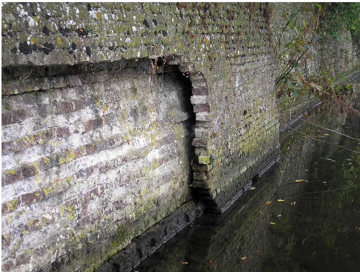
25 Feuille de maçonnerie détachée par le gel. Bastion Katten , face gauche. (RGD, A&A)
