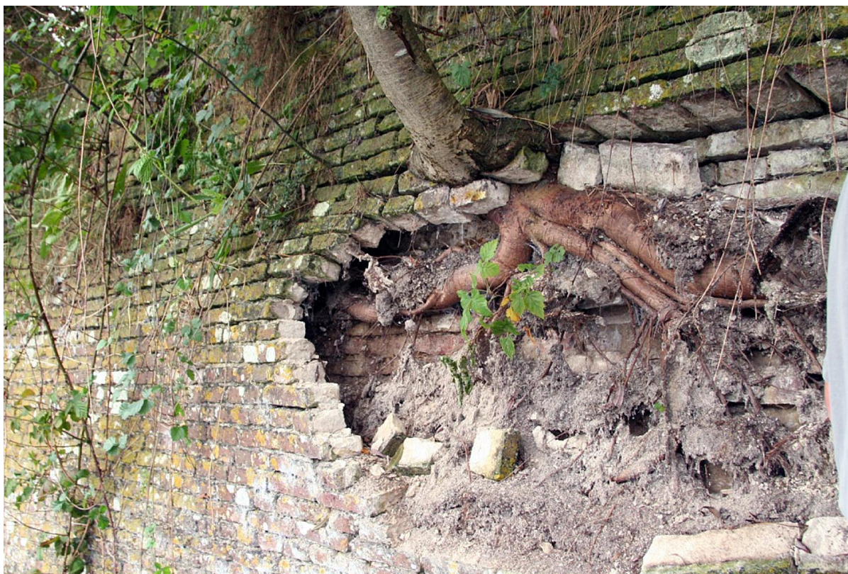
38 Un plant s'est développé dans la feuille extérieure de la maçonnerie qui s'était déjà brisée et y cause la poursuite des dégâts. (RGD 2008)
