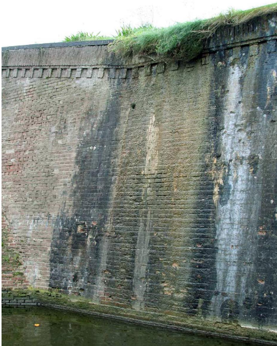
24 Exsudations entraînant des traces de fer provenant du sol derrière le mur et de la chaux provenant de la maçonnerie. Bastion Oranje , face gauche. (RGD)
