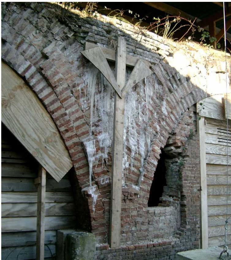
18 L'humidité du mur gèle sous forme de cristaux et forme aussi des glaçons. Un phénomène pareil se voit dans des grottes à stalactites. Lunette B à Breda avant la rénovation. (Rothuizen Van Doorn 't Hooft, Eric-Jan Brans)
