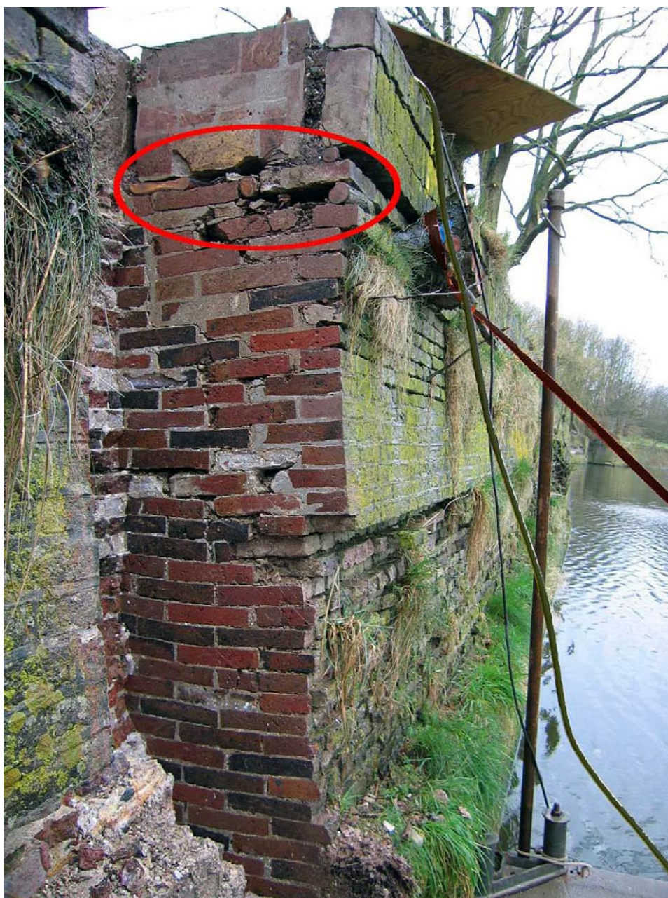
27 Coupe du mur où l'on voit l'éclatement d'une feuille de la maçonnerie et les racines poussant dans les fentes. Face gauche du bastion Katten . (RGD 2007)
