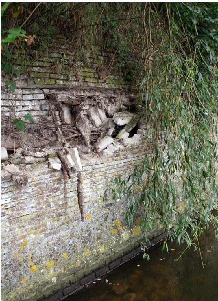
19 Différentes espèces de lichens se voient juste en dessus du niveau de l'eau. Des végétations et des arbres peuvent pousser dans des murs dégradés et des joints ouverts. Dégâts à Naarden. (RGD)
