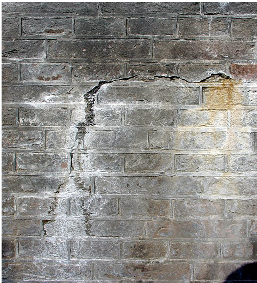
20 Mur lézardé, exsudation d'eau et dépôts de minéraux à la Porte d'Utrecht à Naarden. (André Hoek 2004)
