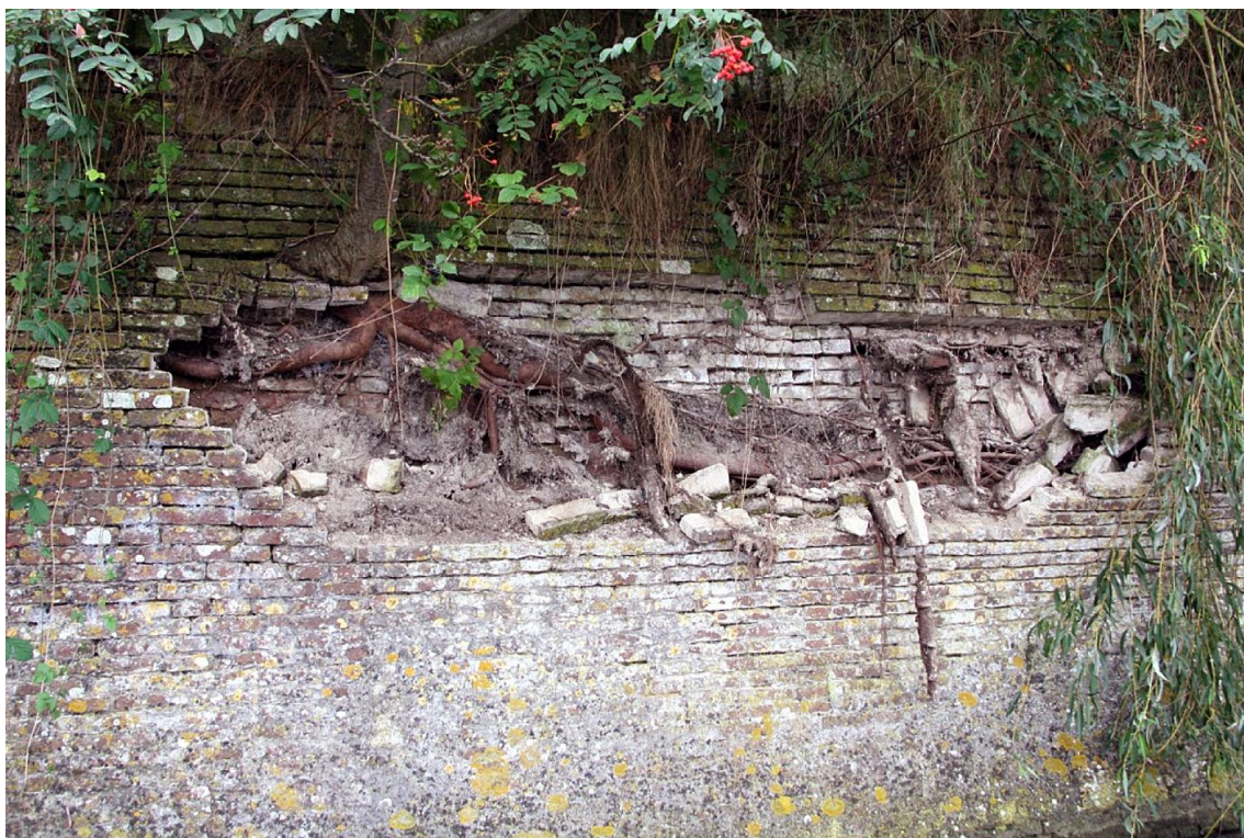
31 Eclatement d'une feuille de maçonnerie, causé par la graine d'un arbre qui s'est installée dans un joint d'où le mortier de jointoiment avait disparu et où l'arbre a pu développer des racines. Courtine entre les bastions Katten et Oud-Molen . (RGD)
