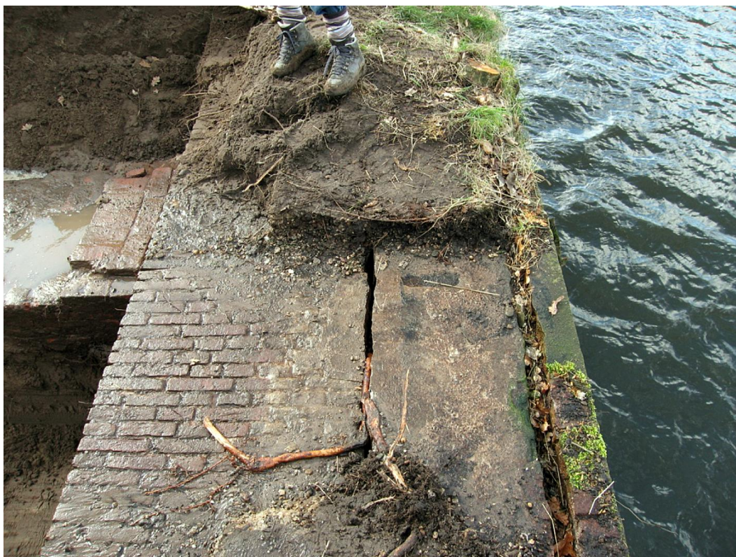
21 A gauche la partie du mur datant du 17 me siècle, à droite la maçonnerie extérieure (enduite de mortier sur la crête) qui est appliquée lors d'une restauration au 19 me siècle. Un arbre a pu pousser entre les deux. La feuille extérieure à l'épaisseur d'une demie brique s'est détachée par les effets du gel. Courtine entre les bastions Katten et Oud-Molen . (RGD 2009)
