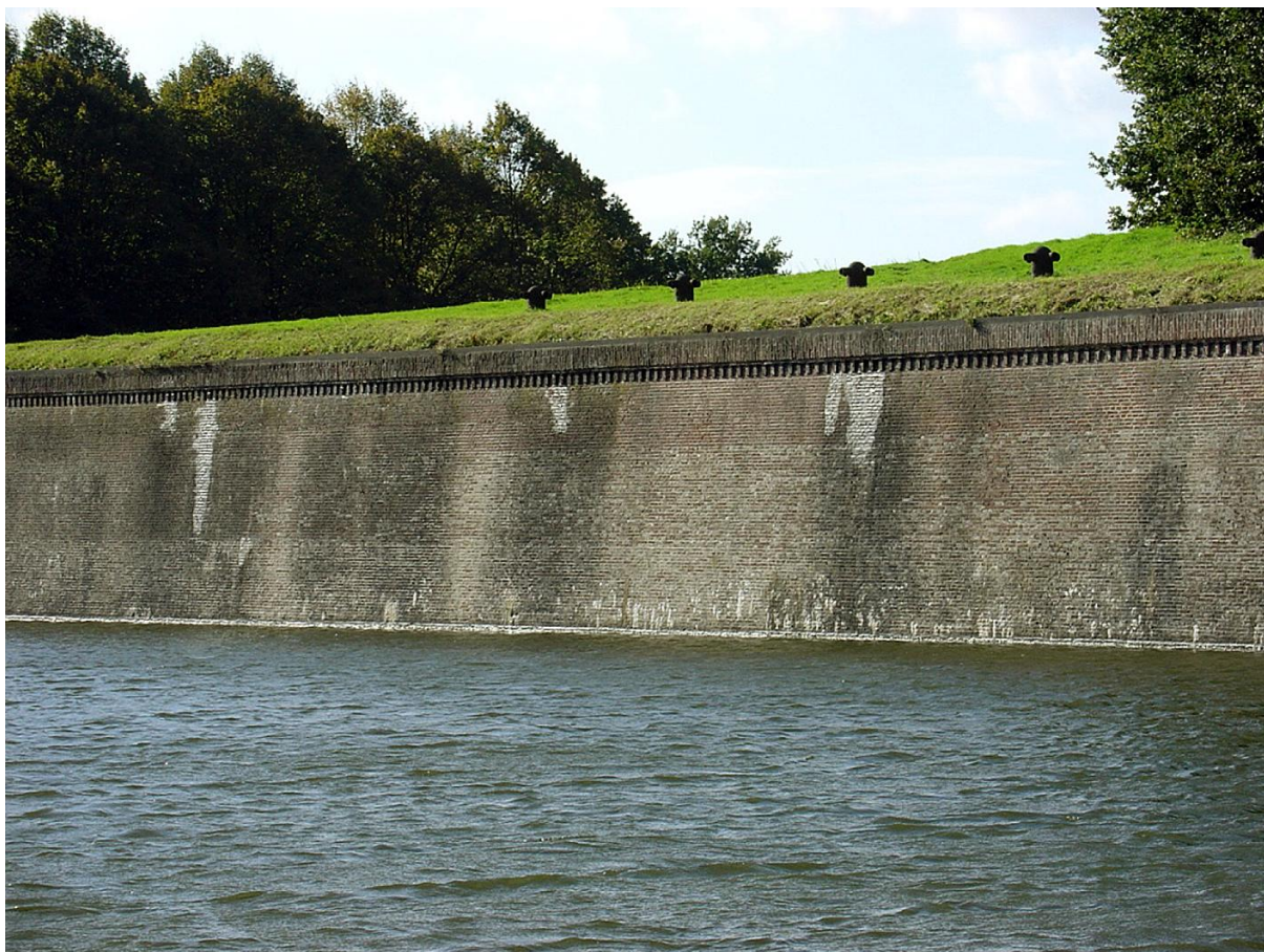
42 Eaux pluviales suintantes à travers le mur de revêtement de la face gauche du bastion Oranje . (André Hoek 2007)
