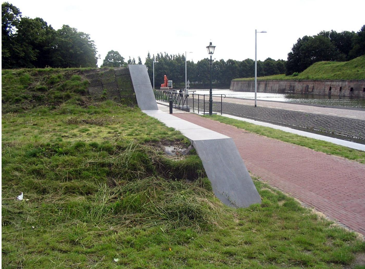
10 La demi-lune no. 6 après la réception en 2003. Les mottes de gazon se détachent par endroits, ce qui rend la membrane sous-jacente sensible à des dégâts. (RGD)
