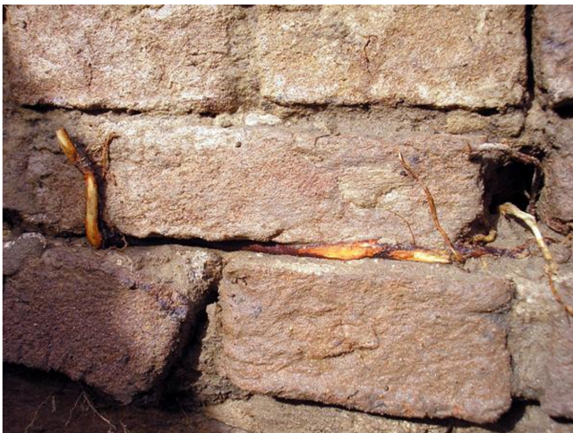
33 Une racine qui cherche le chemin le plus facile. Un joint défailant forme un bon passage vers la terre nutritive. (Jan Kamphuis, 2009)
