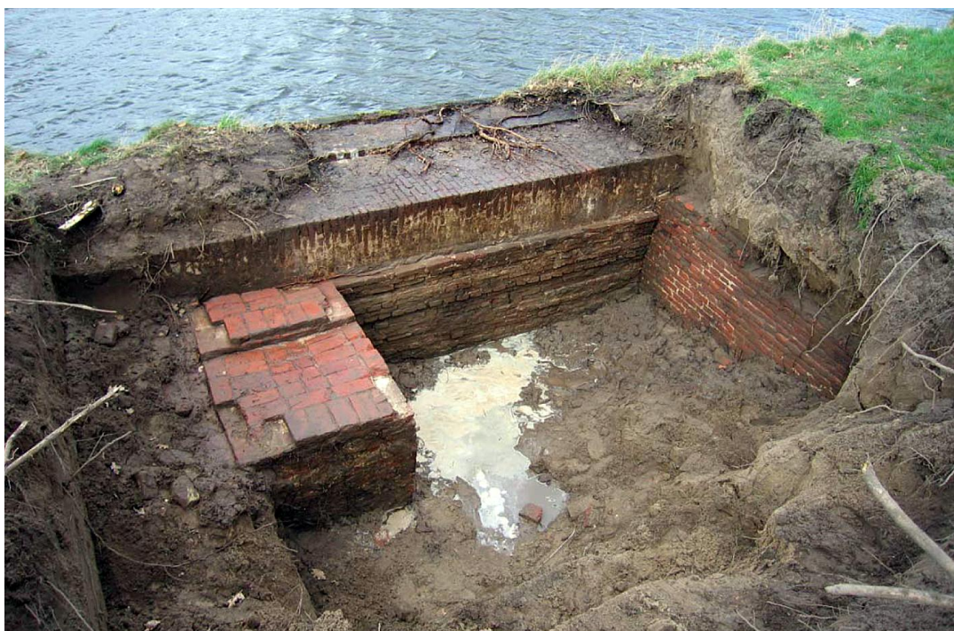
22 Lors des fouilles derrière le mur de la courtine entre les bastions Katten et Oud-Molen on a pu constater l'épaisseur et la construction du mur de revêtement et des contreforts. A l'intérieur du mur il n'y a ni de dégâts par le gel ni des racines de plantes. (RGD 2009)
