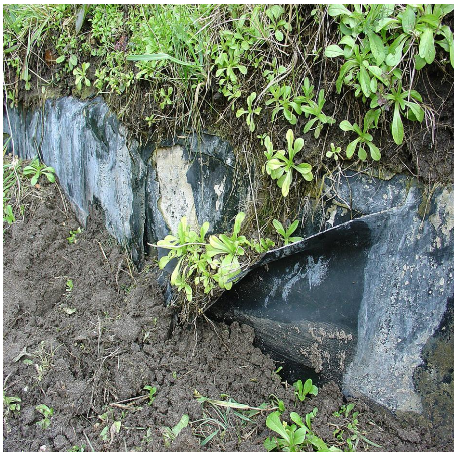
15 Un exemple de dégâts typique. La membrane étanche surgit à plusieurs endroits. Sa dégradation est fortement accélérée par les rayons UV. (A.J.W.Hoek, 2003)
