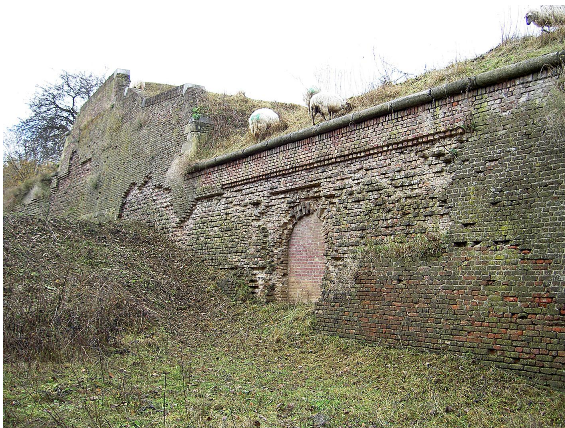
16 La congélation a causé l'éclat de feuilles de briques aux murs de revêtement à Maestricht. (RGD, 2007)
